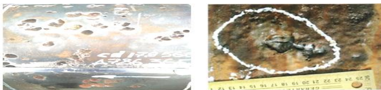
Şəkil 1. MB-da korroziyalı yarielliptik çatabənzər qüsurlar
